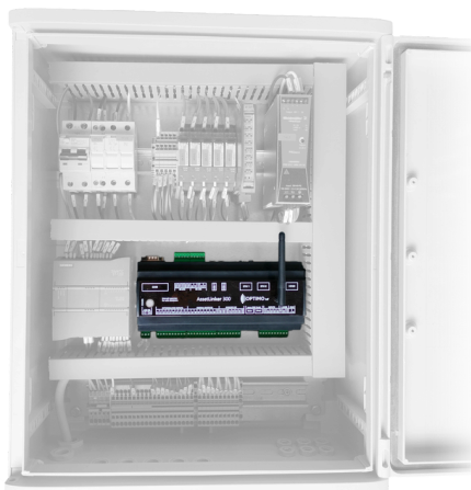
quadro elettrico di monitoraggio
